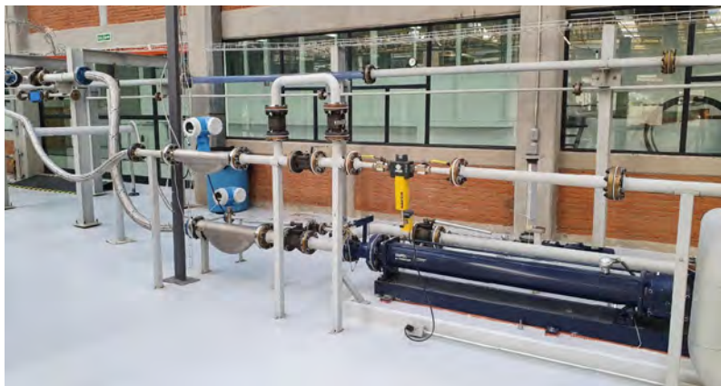
Fig. 1. Zona de máquinas del sistema experimental
